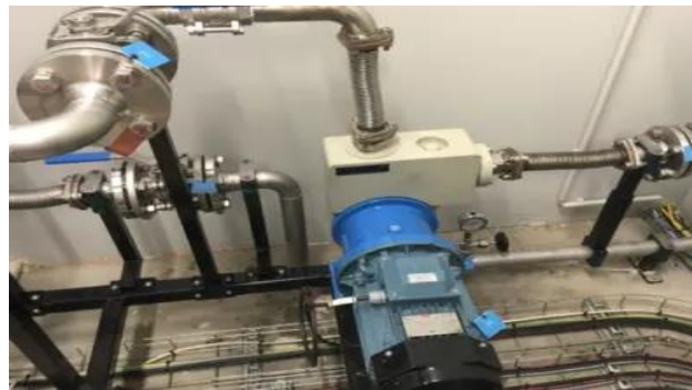
Systeme de récupération d'eau
